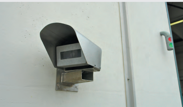
Dieses Gerät erfasst das Fahrzeugkennzeichen, die Leuchte an der Wand signalisiert Einsatzbereitschaft der Anlage.
